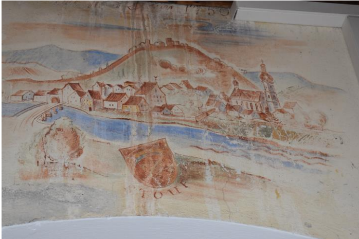
BU: An den Bildern vom Fritz Wurmdobler im Schlossbergturm sind die Wasserschäden deutlich zu sehen. Foto: Sabine Norgall, Markt Regenstauf
